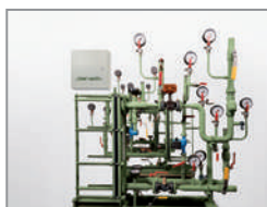
АВТОМАТИЗИРОВАННЫЕ ТЕПЛОВЫЕ ПУНКТЫ
